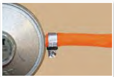
Slanganslutning vid reducerventil
